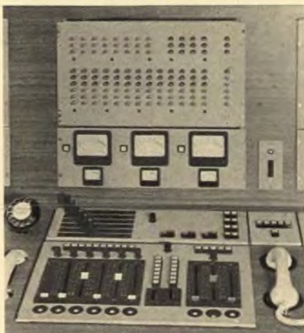
Teilaufnahme des Regietisches für die internationale Regie (Intervision, Eurovision) mit Toneinstellern, Aussteuerungskontrolle und Vierdraht-Vermittlung für Fernsprechen (Aufn.: W. Franz KG, Lahr)
